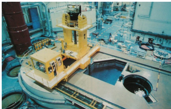
Zavážecí stroj nad reaktorem v EDU
